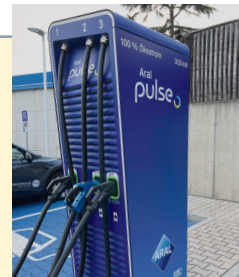
Stromzapfsäule: Das Laden bei Aral lief insgesamt gut.
